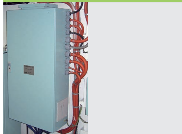
The OCA, Overfill Alarm Cabinet
